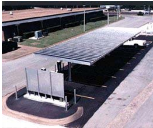
Fig.94 - Pensilina parcheggio a copertura fotovoltaica per la ricarica di auto elettriche (Enea).
