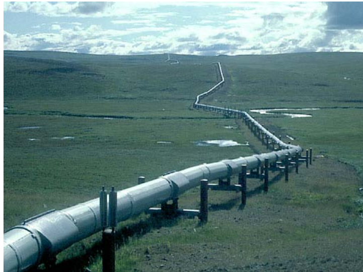
Fig.23 - Immagine di un gasdotto su terraferma
