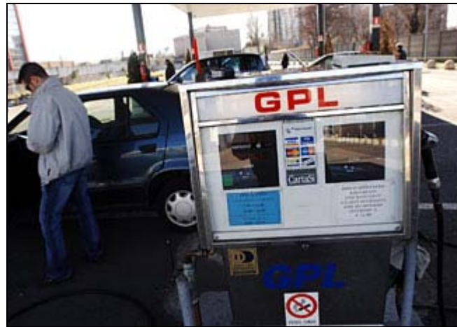
Fig.46 - Impianto di rifornimento GPL
