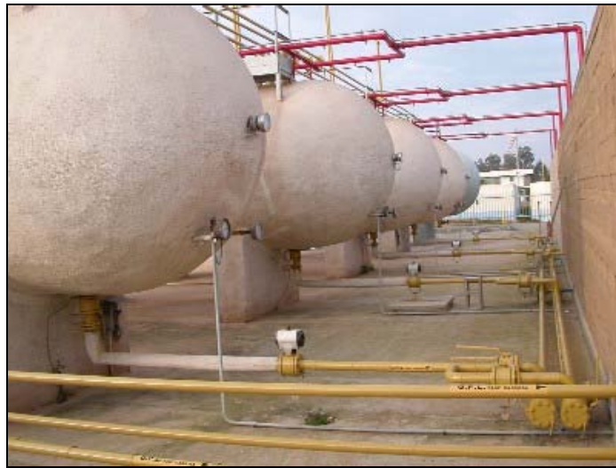
Fig.43 - Serbatoi fissi per GPL uso industriale.
